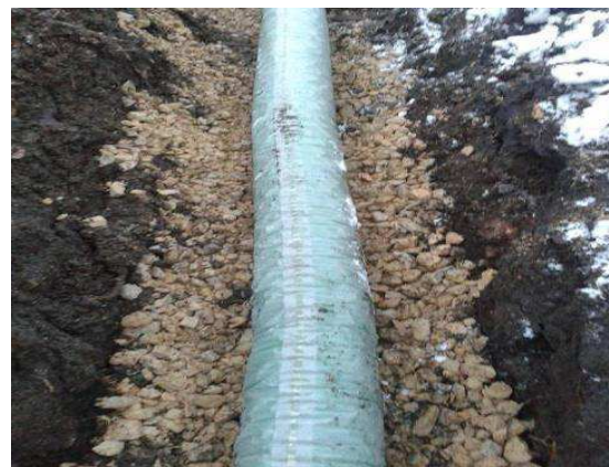
Рис. 2.12 — Газосборная траншея с дренажной трубой (Пермский край) ([47])
